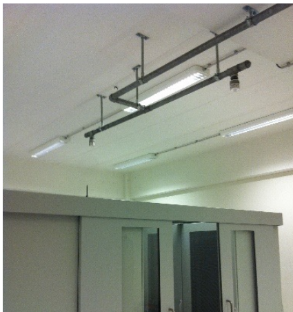
Figuur 6.7 Leidingwerk met nozzles
